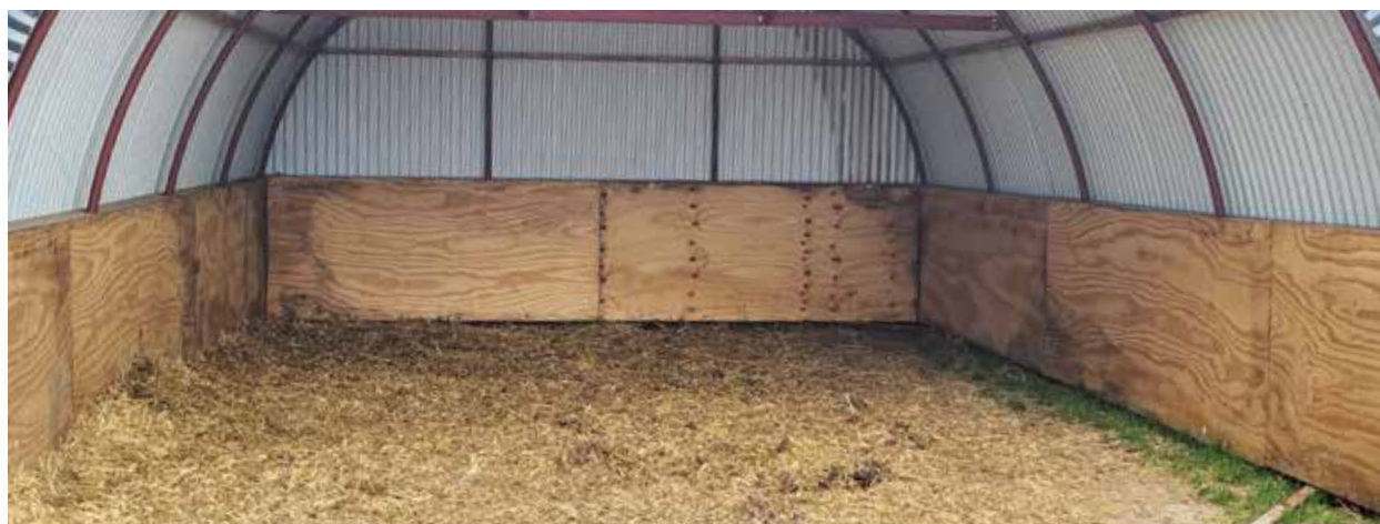
Billede 17. Træplader beskytter hallen indvendigt
